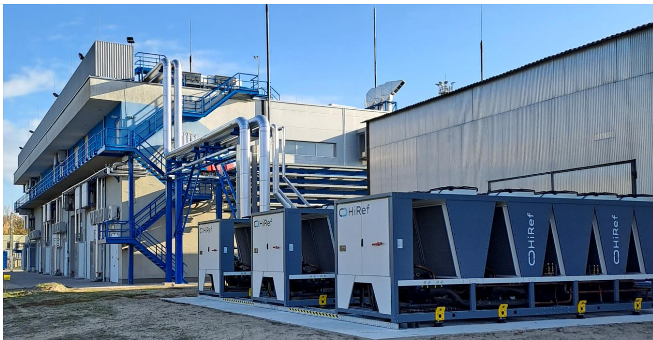
2. sz. kép – ZSA / Komprimáló rendszeri épület a kiegészítő gépi hűtőegységekkel (előtérben)
